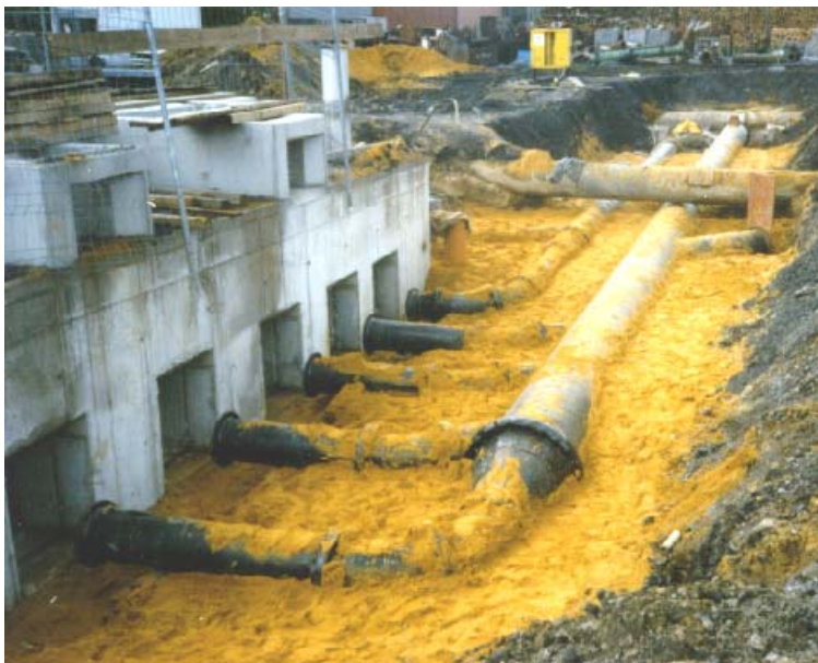
Druckrohrleitungen außerhalb des Pumpwerks
