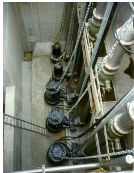
Blick in den Pumpenraum
